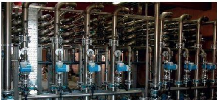
Impianto MBR Isola di S.Erasmo (VE) potenzialità 4.000 A.E Sistema a recupero energetico (brevettato).
